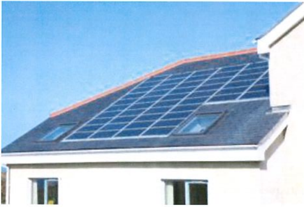
Panneaux photovoltaïques intégrés
